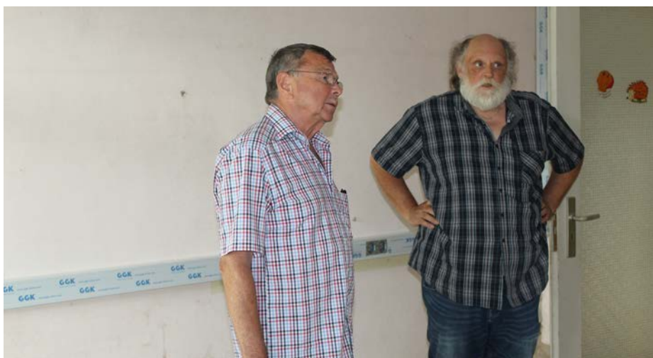
Gerhard Fischer (links) und Joseph Joas beratschlagen über die nächsten Schritte bei der Sanierung des ARBE-Hauses. Bild: Birgit Böllinger
